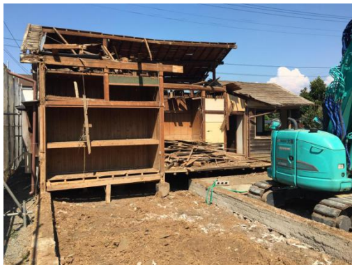
破損により、取り壊される隈府教会（旧会堂）
